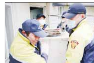
강원 정선 고한읍의용소방대는 23일 어려운 이웃들을 위해 노후 보일러교체 봉사활동을 실시했다. <고한읍의용소방대 제공>
